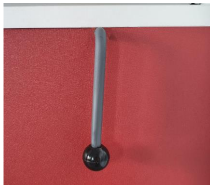
Abbildung 9: Kurzschlussklappenhebel in geöffneter Stellung.
