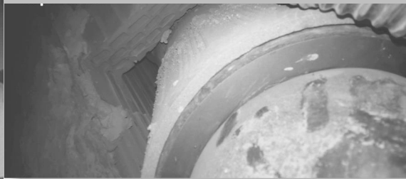
niewłaściwe podłączenie przewodu spalin i brak dyatacji czopucha
